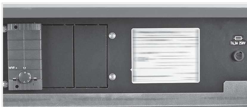
Targhetta davanti sul quadro di comando sotto il pannello di rivestimento
